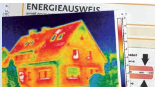
Wärmebild einer ungedämmten Hauswand
