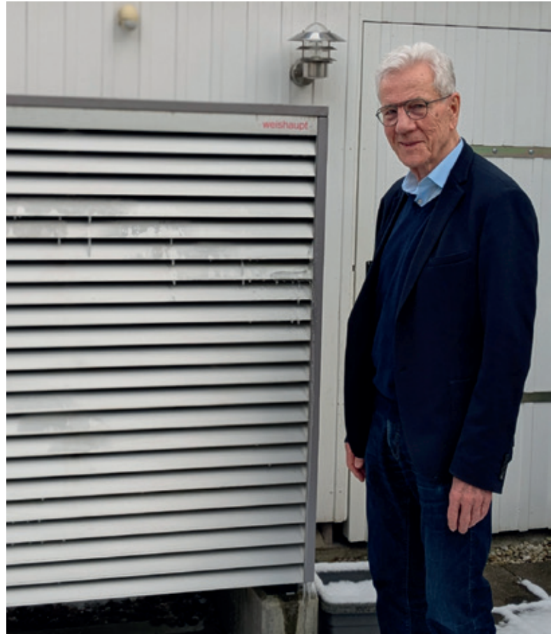
Nach intensiver Auseinandersetzung mit Energie- und Nachhaltigkeitsthemen entschied sich Dr. Volker Hauff gemeinsam mit der Firma Hinz für den Umstieg auf moderne Wärmepumpentechnik.
